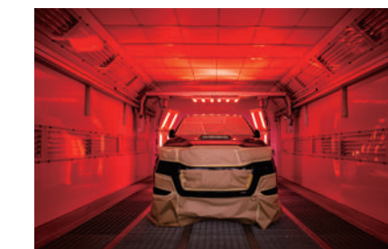
塗装ブースの風速・温度管理
