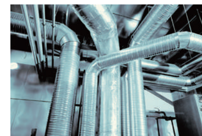
分岐配管の風量調整
